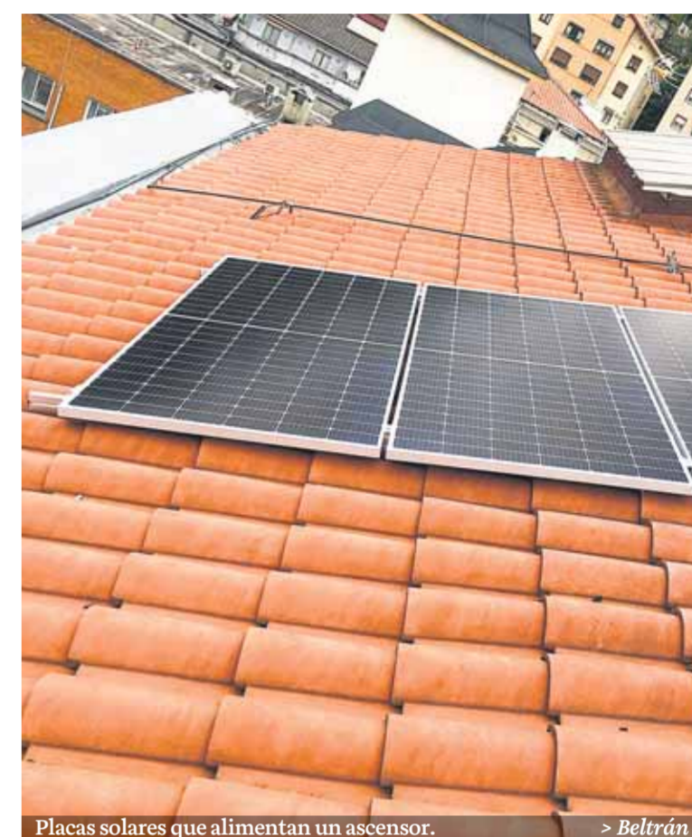
Placas solares que alimentan un ascensor.
